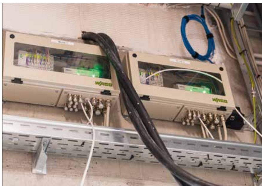
Installationen er omfattende. Bl.a. er der omsat 44 af disse bokse, der rummer DALI-udstyr fra Wago.
