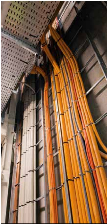
Kabler i alle størrelser snor sig rundt i bygningen.
